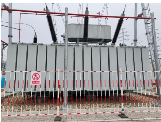
本期新建的 2 号主变
