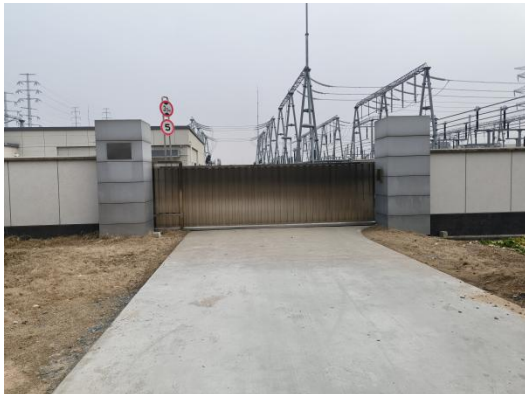
变电站大门及围墙
