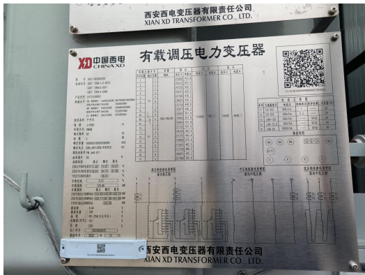
2 号主变铭牌 (绝缘油重 59t)
