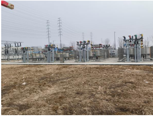
220kV 配电装置区
