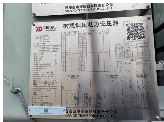
2 号主变铭牌 (绝缘油重 59t)
