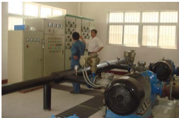
灰场回水系统控制室
